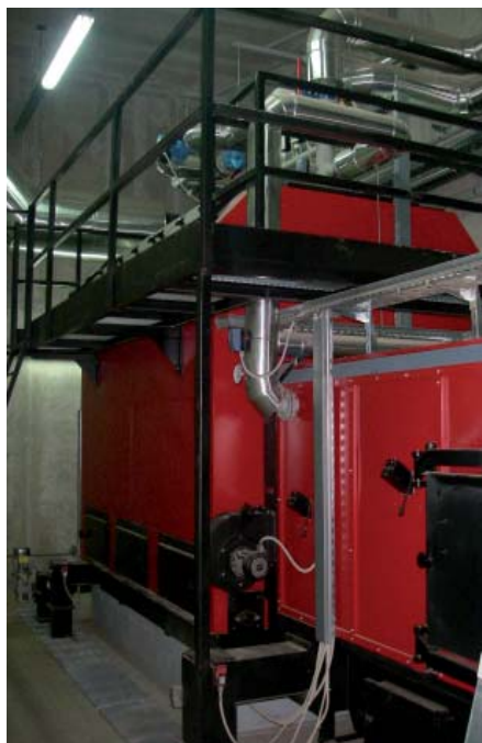
Kotel na lesne sekance
