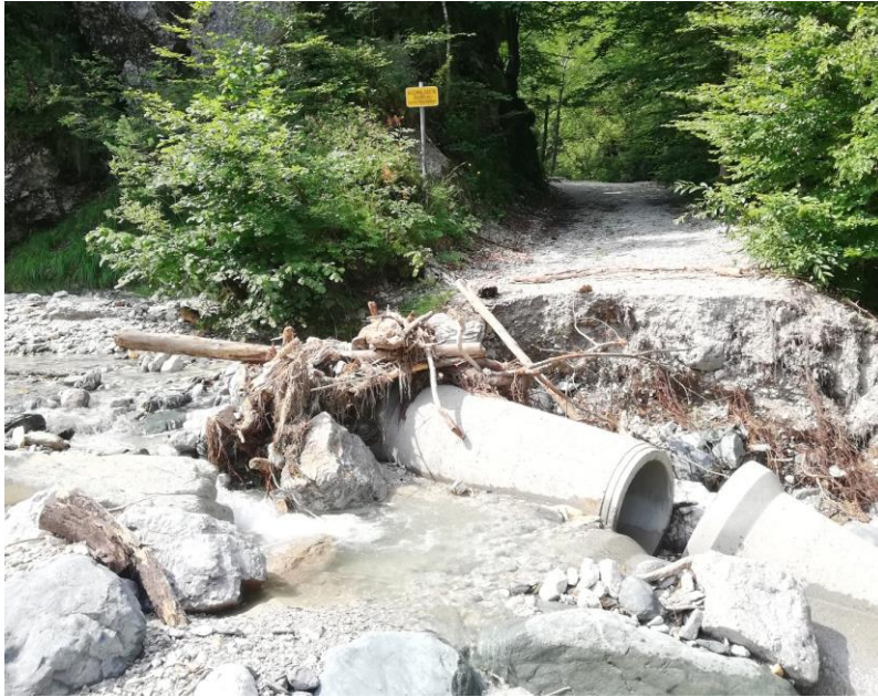
Slika 5: Cevni prepust zamašen z lesnim plavjem je botroval porušitvi odseka gozdne ceste (Foto: Saražin J.)
