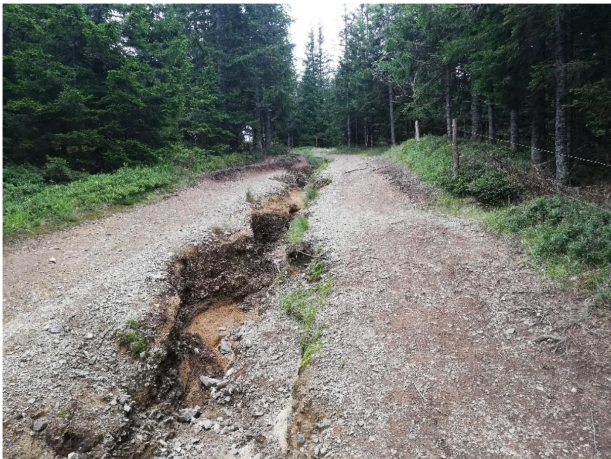
Slika 4: na močno erodibilnih podlagah so lahko že nizki nakloni problematični in je na njih potrebna umestitev prečnih jarkov
